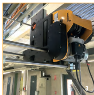
3. Un MOTORBOX dans un site industriel.
